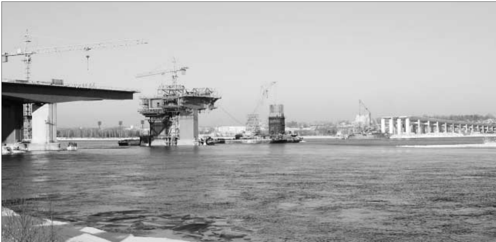
Weil das Geld fehlt, bleibt in Irkutsk die Brücke über die Angara nur zur Hälfte gebaut. (Bilder Christian Weisflog)
